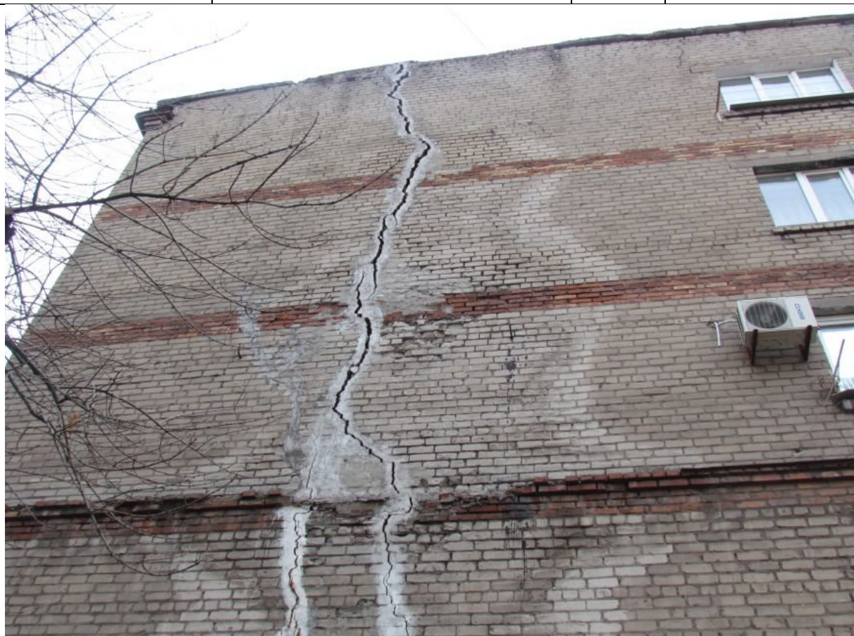
2-rasm. Devorning butun balandligi bo'ylab poydevorning buzilishi natijasida yuzaga kelgan yoriq. Cheklangan xizmat ko'rsatish holati.
